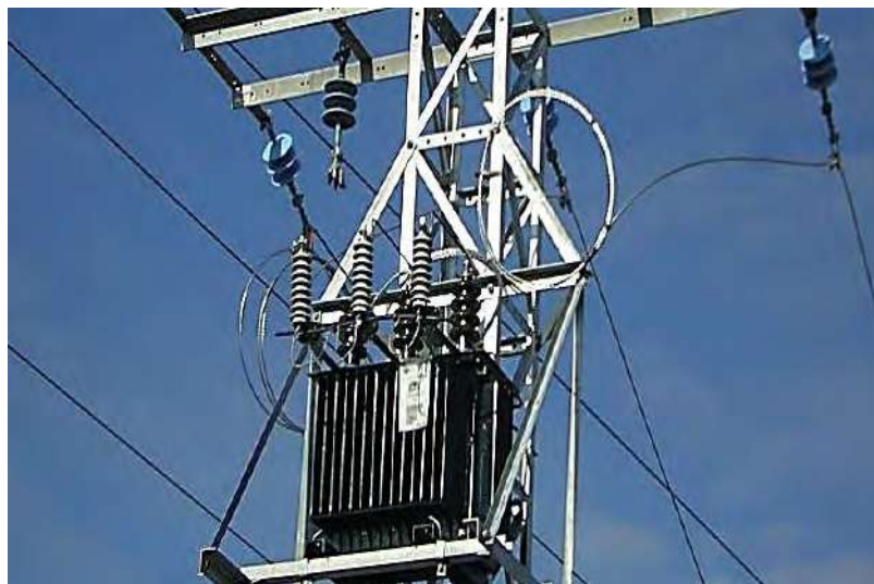
Figura No. 3.22 Transformadores típicos utilizados en las sub-estaciones de distribución de energía eléctrica.
