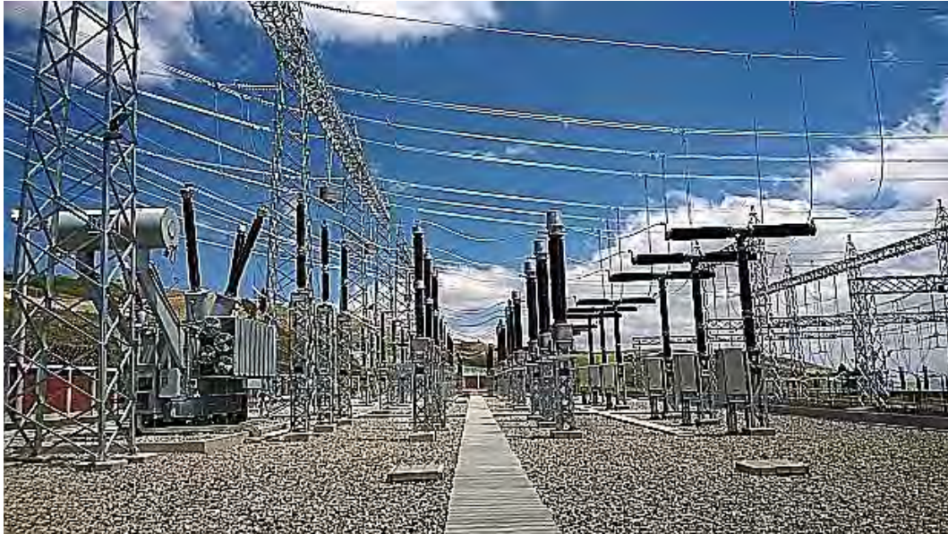
Fig. No. 1.4 Vista de la cabecera de una red de reparto de energía eléctrica.
