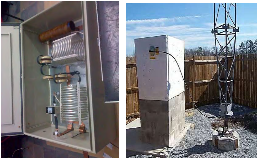
Figura No. 5.30 Gabinete de un acoplador de antena para un caso real de una emisora AM y su conexión a la antena radiador.
