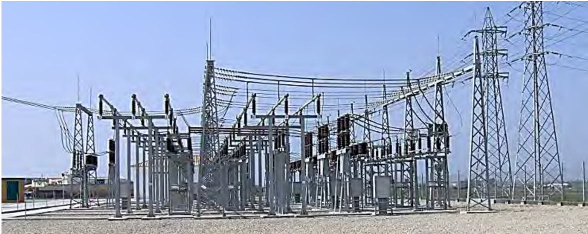
Figura No. 3.18 Vista panorámica de una subestación de reparto o de transformación.
