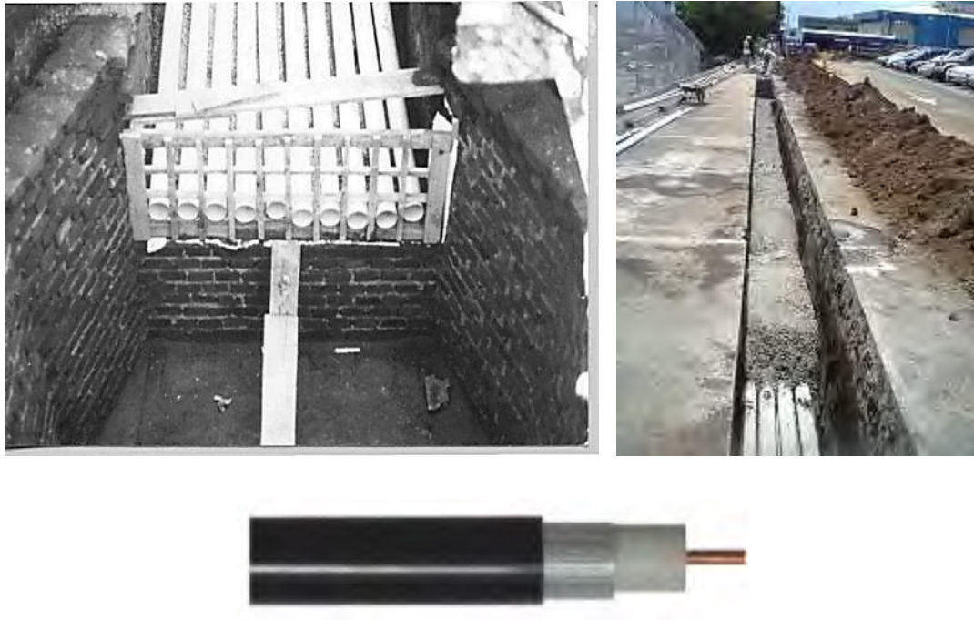
Figura No. 5.47 Tendido de los ductos para redes de cable coaxial subterráneo e imagen de un cable-500.
