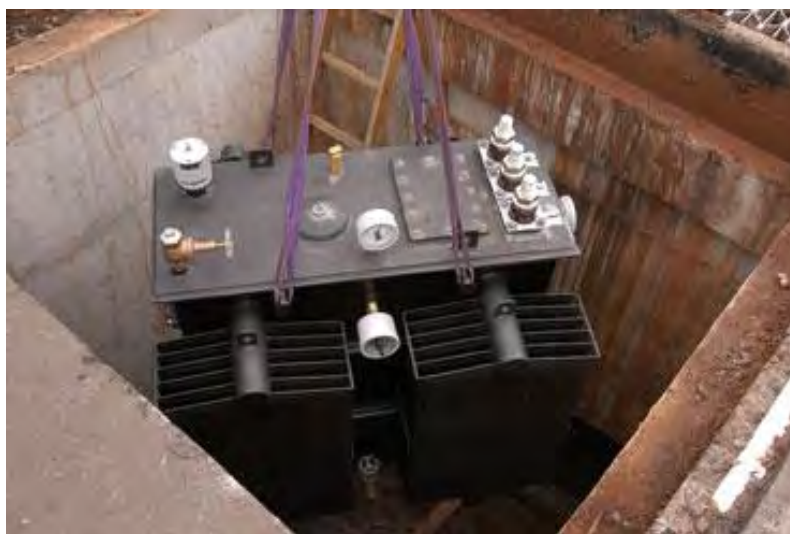
Figura No. 3.51 Transformador de montaje tipo subterráneo (bóveda).
