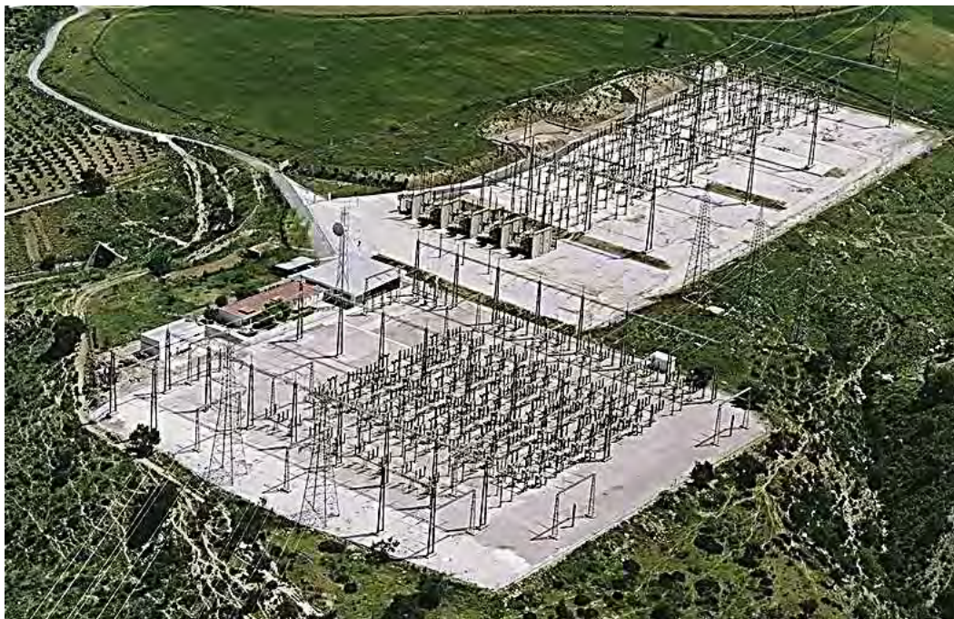
Fig. No. 1.3 Esta panorámica de una subestación de reparto o de transformación.
