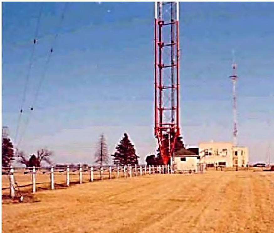
Fig. No. 1.17 Interconexión entre transmisor de una estación de radiodifusión AM y su torre-radiador.
