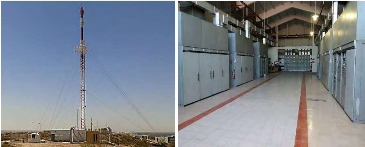
Figura No. 7.4 Imágenes de un radiador y de la sala de equipos de la estación transmisora de una emisora AM.
