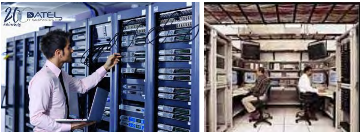
Figura No. 4.24 Imágenes de las instalaciones de un cuarto de equipos para redes de cableado estructurado .
