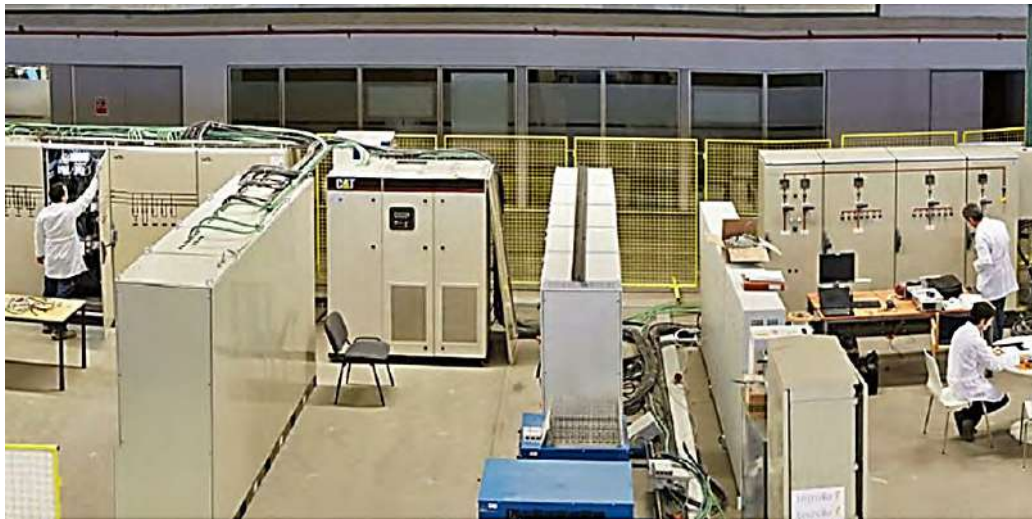
Figura No. 3.6 Imágenes de diferentes tipos gabinetes de monitoreo y control en una estaciones de transmisión de energía eléctrica.
