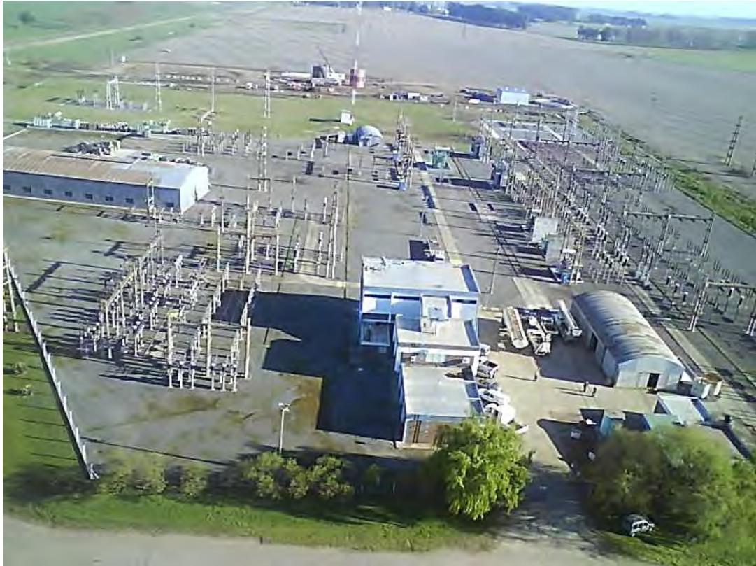
Figura No. 3.11 Imagen de la panorámica de una estación de transmisión de energía eléctrica.
