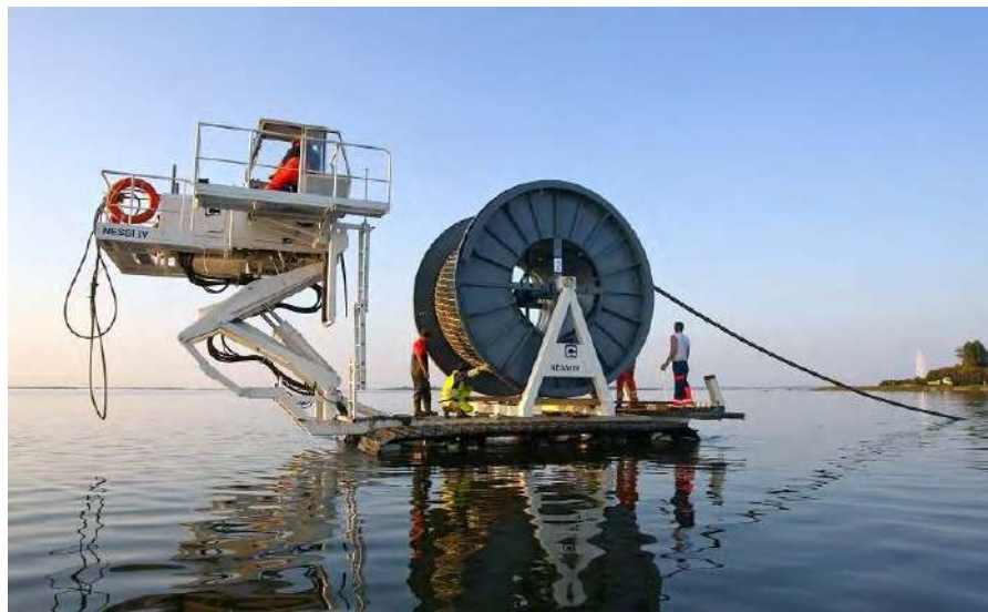
Figura No. 9.35 Imágenes excavación sobre el litoral, preparativos para la iniciación del enterramiento del cable submarino sobre la plataforma continental y tendido correspondiente en esta trayectoria inicial
