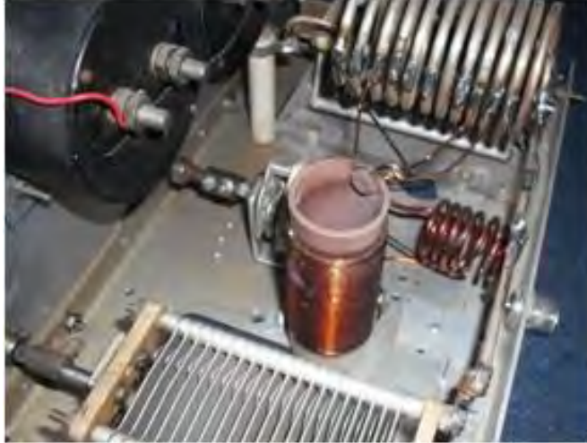
Figura No. 7.10 Imágenes de acopladores de antena (cajas de sintonía) para casos reales de una emisora AM .
