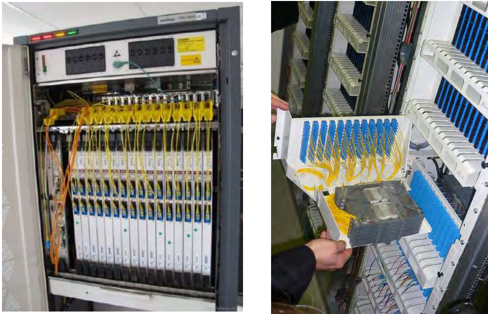
Figura No. 10.33 Imágenes de salas de equipos OLT ( Optical Line Termination ).
