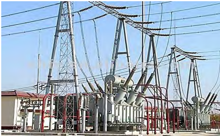
Figura No. 3.8 Imágenes de transformadores de alta tensión empleados en las estaciones y redes de transmisión.
