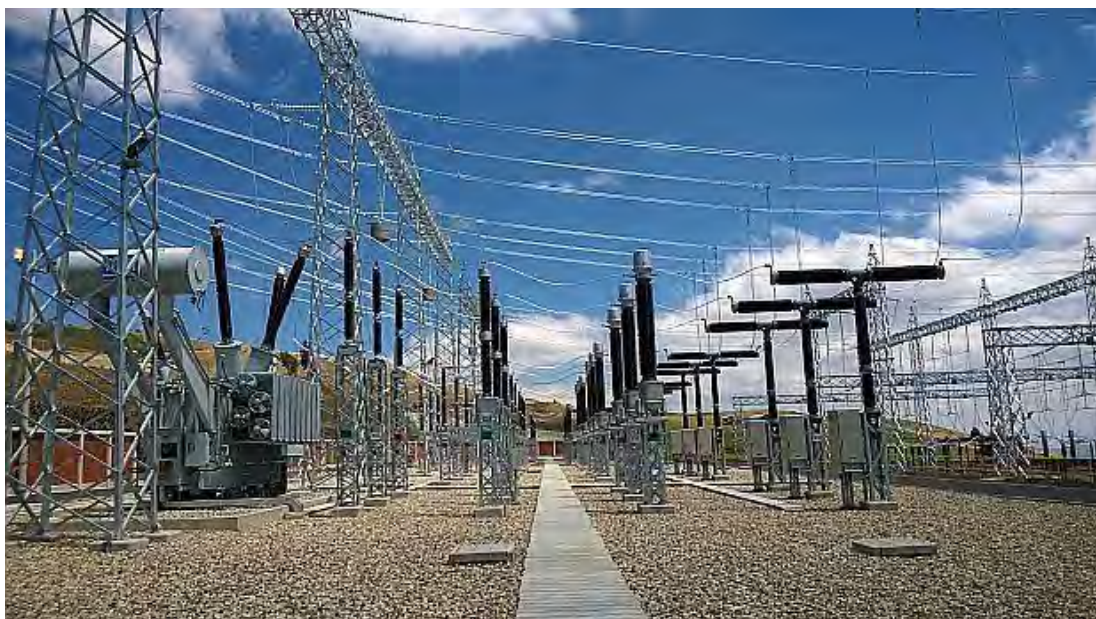
Figura No. 3.19 Vista de la cabecera de una red de reparto de energía eléctrica.
