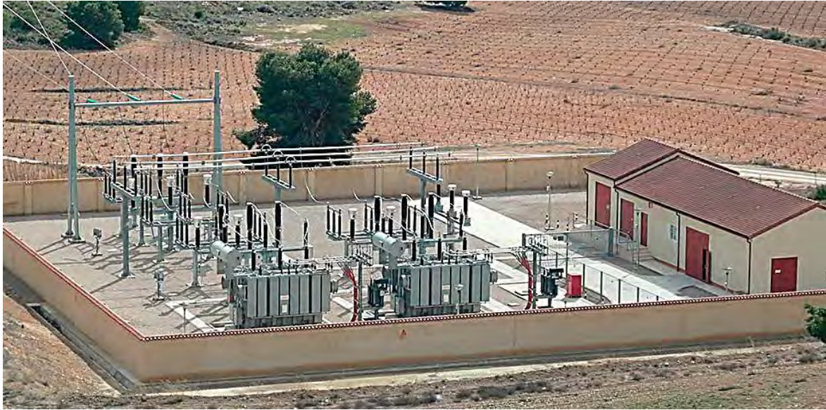
Figura No.3.20 Vista panorámica de una subestación de distribución.
