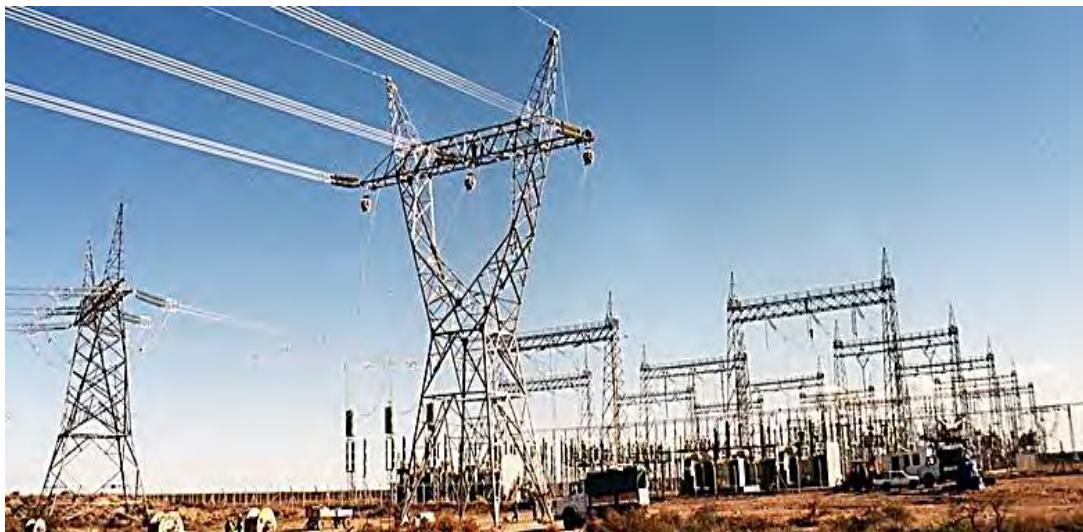
Figura. No. 3.17 Panorámica de la iniciación de una red de una estación de transmisión de energía eléctrica.
